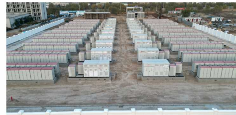
三门峡50MW/100MWh共享储能项目
